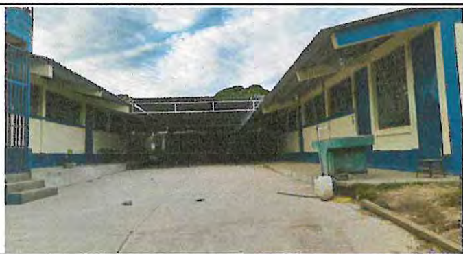
Foto 5: Área del techo sin canales
