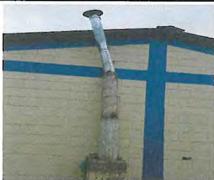
Foto 5: Chimenea de cocina
